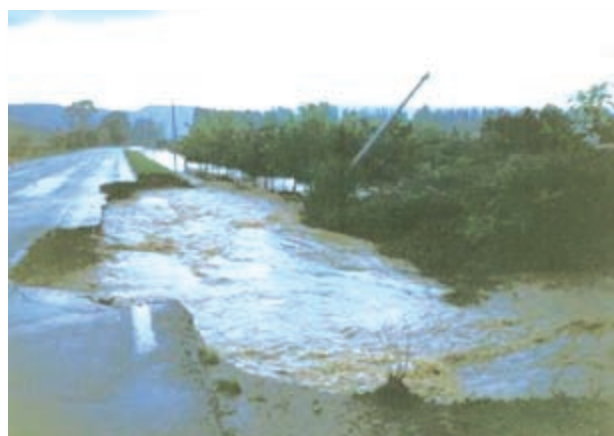
Affaissement sous une route départementale.
