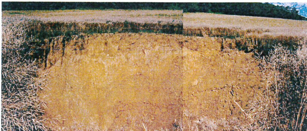
Illustration 8 – Effondrement d'une vingtaine de mètres de diamètre sur une dizaine de mètres de profondeur survenu en juillet 2007 sur la commune de Courcuire
